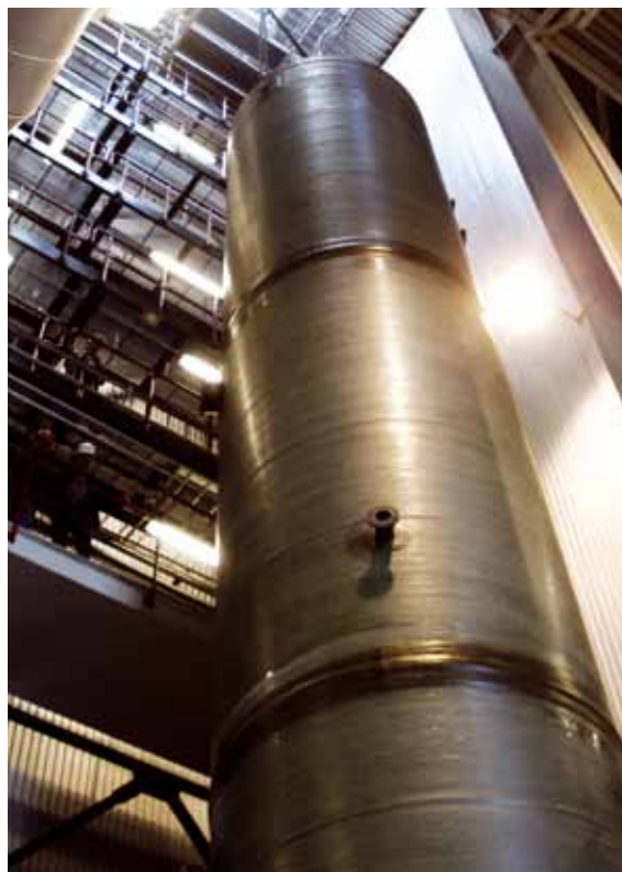
Installation av en skrubber som hanterar smutsiga rökgas ger effektiv värmeåtervinning som distribueras över fjärrvärmånätet
