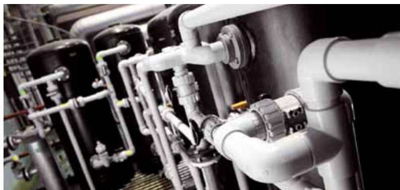
Leverans av avancerad vattenreningsutrustning ingår ofta i vårt åtagande.
